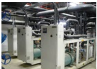
Geotermikus hőszivattyú a Telenor Házban
